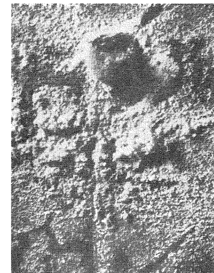
Fig. 47. Geldråbe på betonoverflade, 25 mm diameter.
